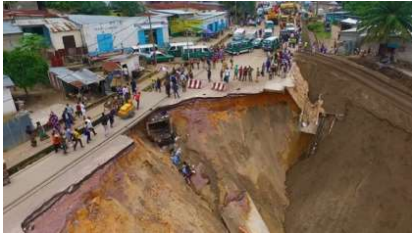
Photo 1 : Phénomène d'érosion à Brazzaville-Congo (quartier Ngamakosso)
