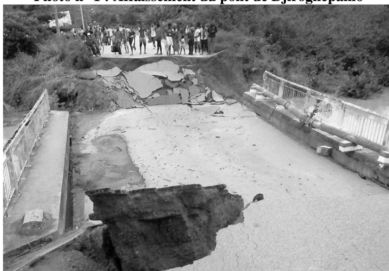
Photo n° 1 : Affaissement du pont de Djirogné pahio
