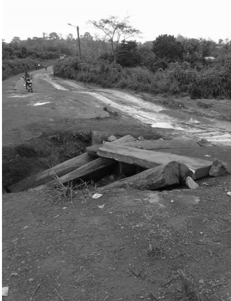
Photo n° 3 a et b : route effondrée par le milieu (a) suite à l'affaissement des buses (b) sur l'axe Yabayo/Issia (village de Gouabouo)
